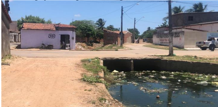
Figura 4 – Ocupação inadequada às margens do sistema de macrodrenagem
