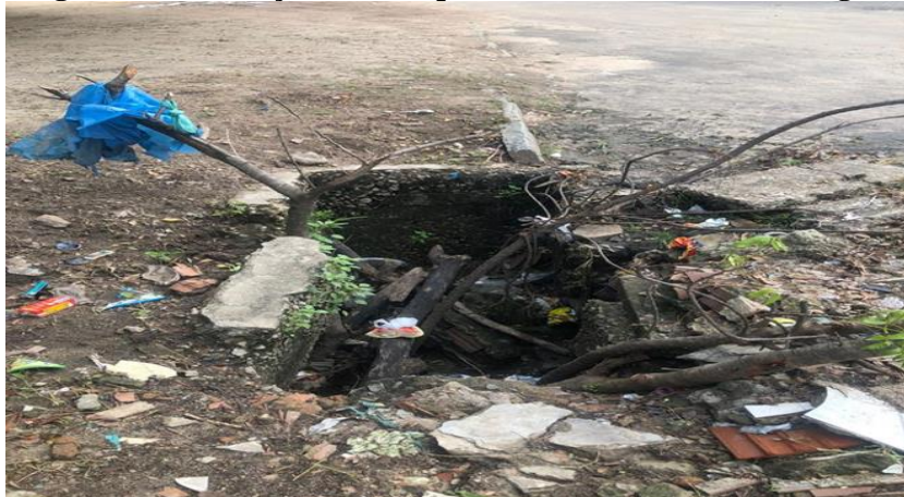
Figura 5 – Obstrução dos componentes do sistema de drenagem
