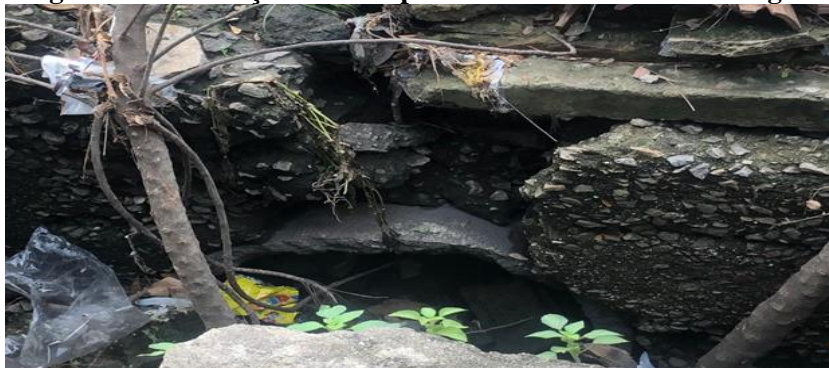
Figura 6 – Obstrução dos componentes do sistema de drenagem
